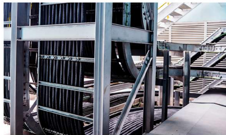
LEITOS E ELETROCALHAS
